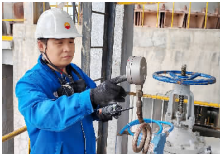
炼油二部员工做好新换热器检查,认真核对压力表数据,做好现场仪表数据核对。通讯员 匡佳玉 摄
